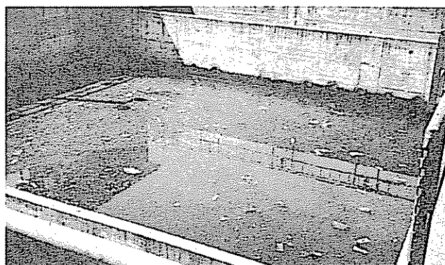
Fig. 5 Sicht auf Regenbecken mit auf der Wasseroberfläche schwimmenden Schmutzstoffen (im Hintergrund Zulauf).
